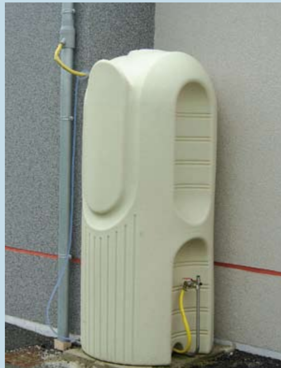
Le système de récupération des eaux
